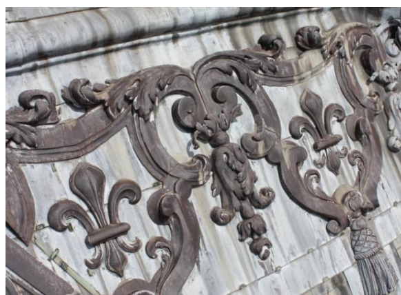
Corrosion brune sur les décors en plomb de la toiture de la chapelle royale de Versailles donnant l'illusion d'une polychromie apparente (XVII e siècle).
