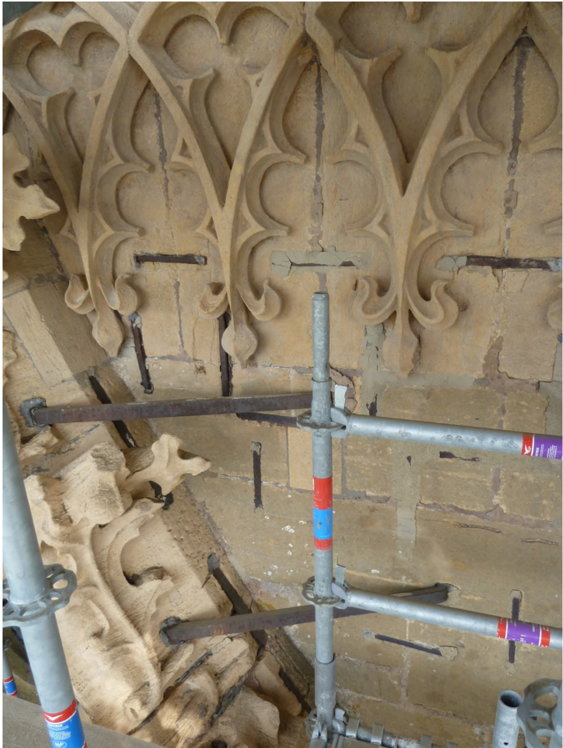
Agrafes de fer scellées au plomb renforçant la structure de la tour de Mutte de la cathédrale de Metz
